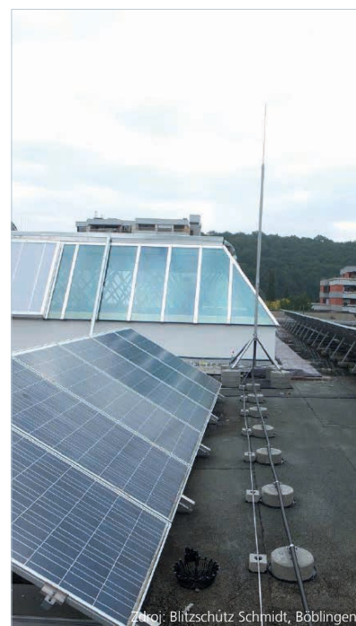
Zdroj: Blitzschutz Schmidt, Böblingen
