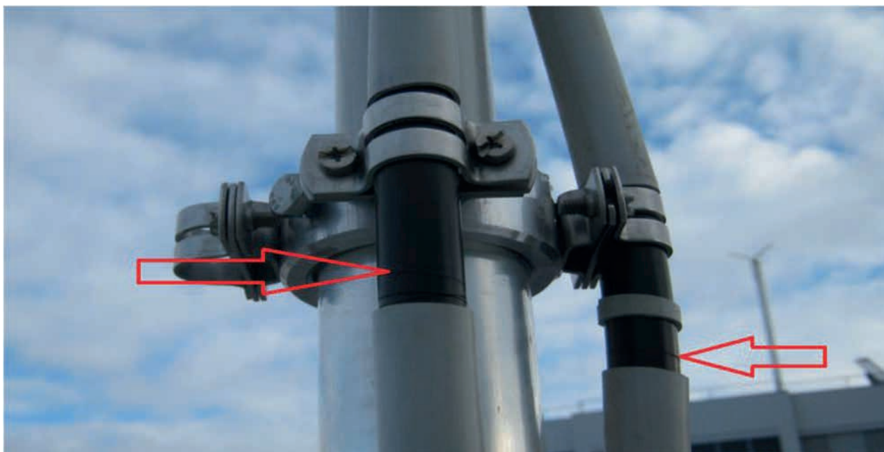
Ukázka poškození vodiče během instalace
