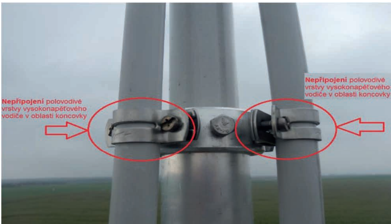
Ukázka chybné instalace – nedodržení montážního návodu
