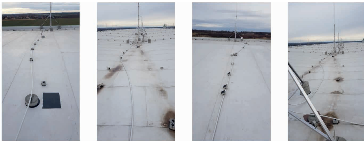
Ukázka poškození jímací soustavy po silném větru
