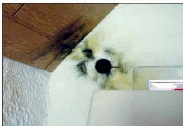
Přeskok blesku po vnitřní stěně pokoje
