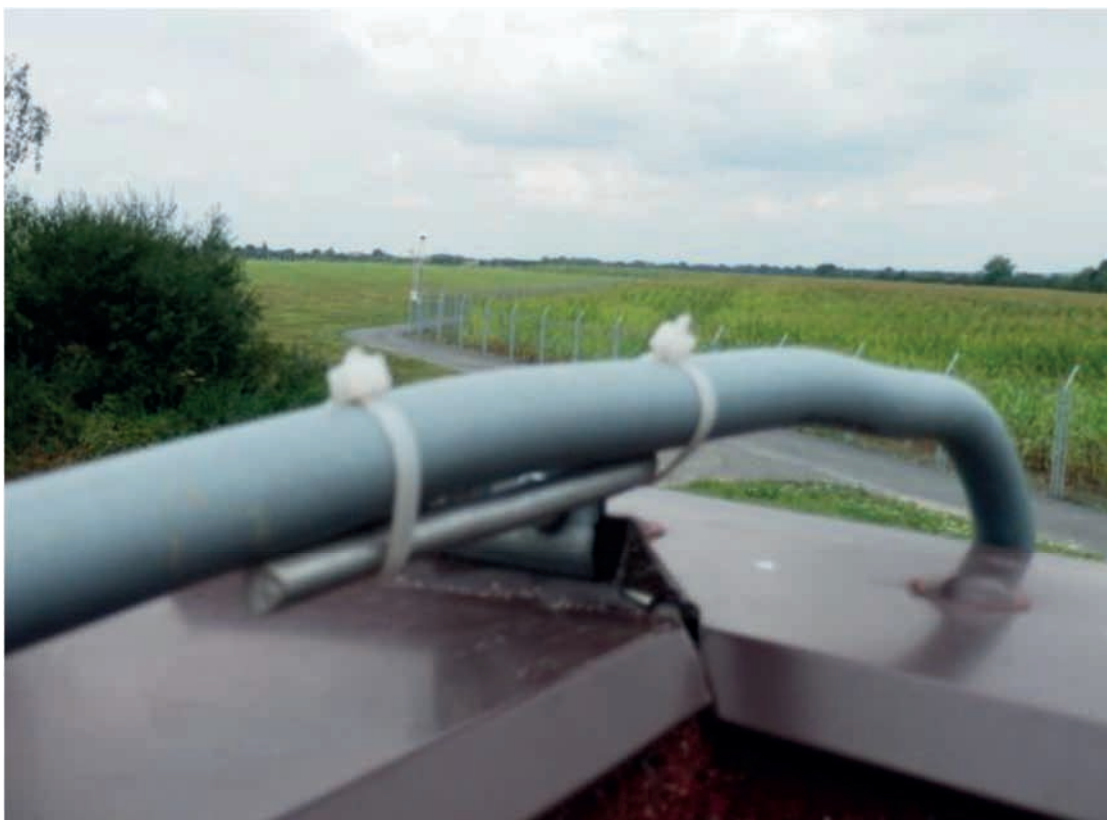
Ukázka nevhodného kotvení vodiče ke stavbě
