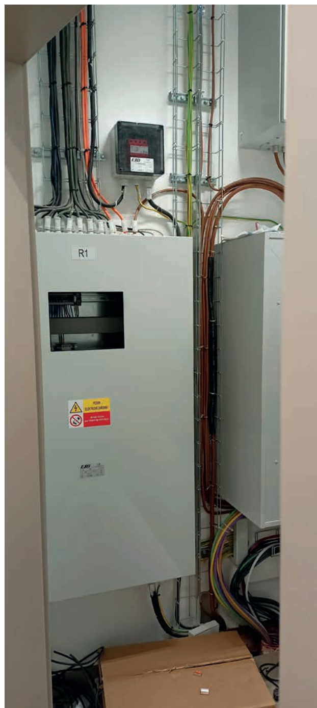
Obr. 10. Svodič přepětí umístěný na napájecím vedení pro rozvaděče
