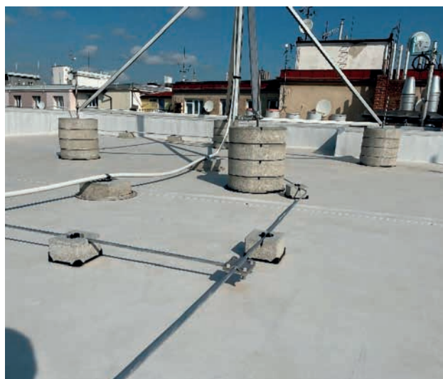
Obr. 12. Rozvod ochranného pospojování na střeše
